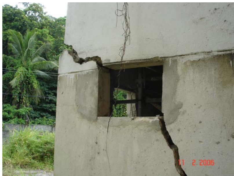
Figura 3.3 – Rachadura no bloco E
