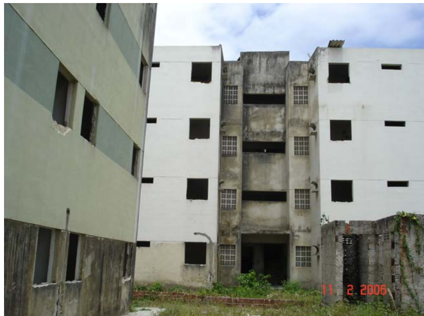
Figura 3.2 – Desaprumo do bloco D.
