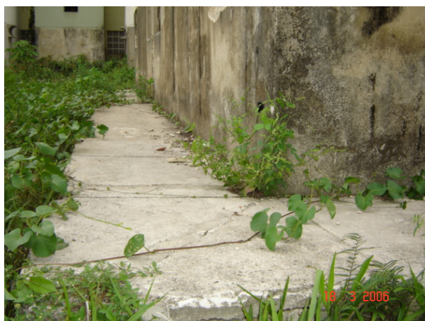
Figura 5.3 – Afundamento do bloco C, inclinação da calçada na direção do bloco.
