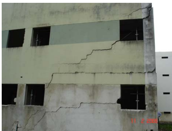
Figura 5.4 – Bloco E – grandes rachaduras
