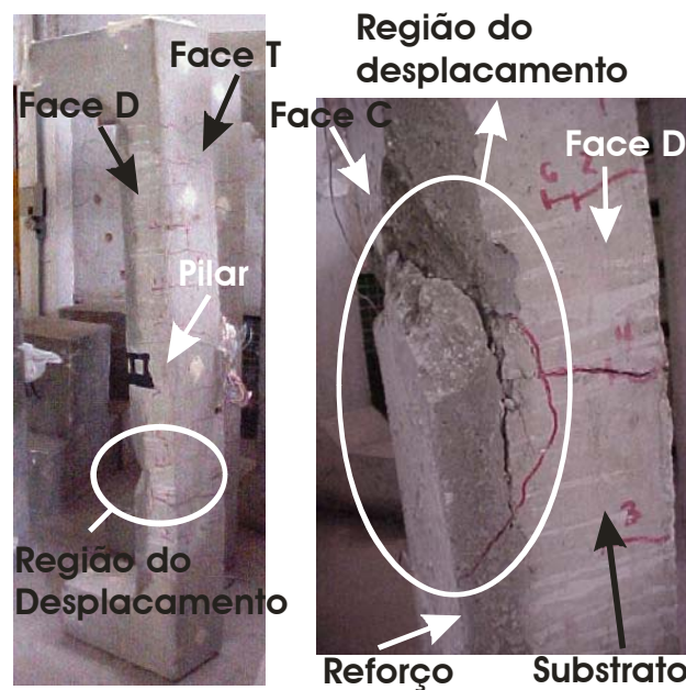
Figura 4.56 – Fotografia do pilar PC35 (reforçado à compressão) após a ruptura
