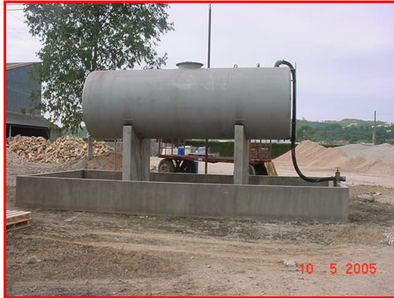
Figura 40: Instalação com bacia de contenção e impermeabilização na descarga
