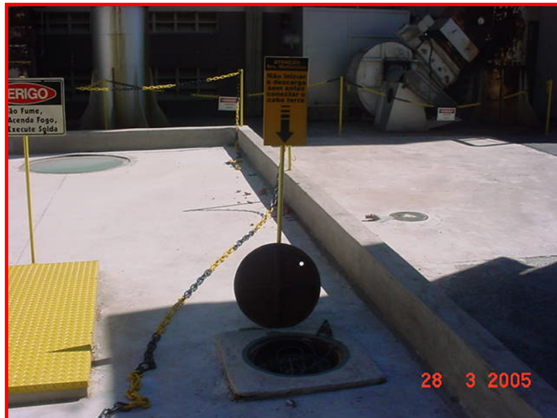
Figura 43: Local de aterramento do caminhão-tanque e placa de advertência ao motorista
