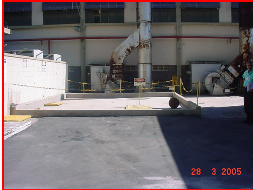
Figura 42: Bacia de contenção da área de descarga
