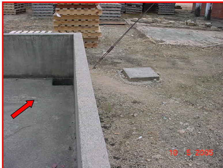
Figura 41: Bacia de contenção com escoamento de água pluvial e tampa da válvula de drenagem
