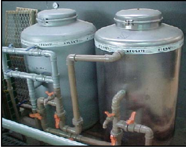
Figura 25 – Vista dos filtros de quartzo e de carvão ativo.
