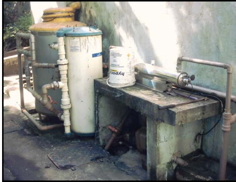
Figura 17 - Vista do tratamento com o filtro de quartzo, o filtro de carvão ativo e equipamento para oxidação com radiação ultravioleta.
