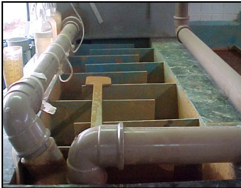
Figura 22 - Vista do floculador hidráulico.
