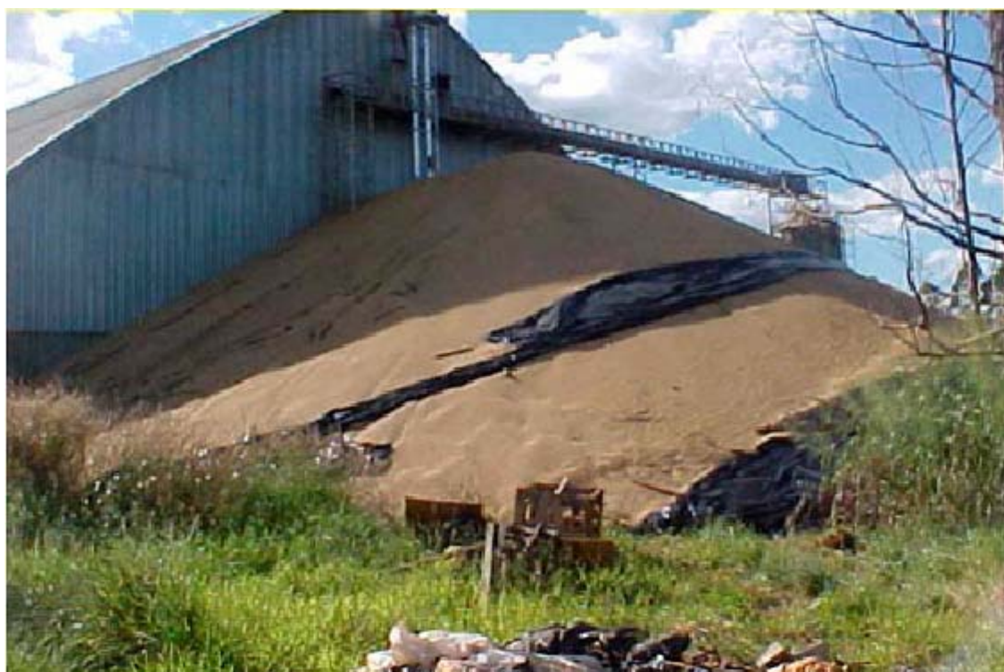
Figura 14. Detalhe da precariedade de armazenamento de parte da safra de grãos por falta de armazéns e de vias em condições de escoar a produção. Fonte: ANUT – Associação Nacional dos Usuários do Transporte de Cargas.
