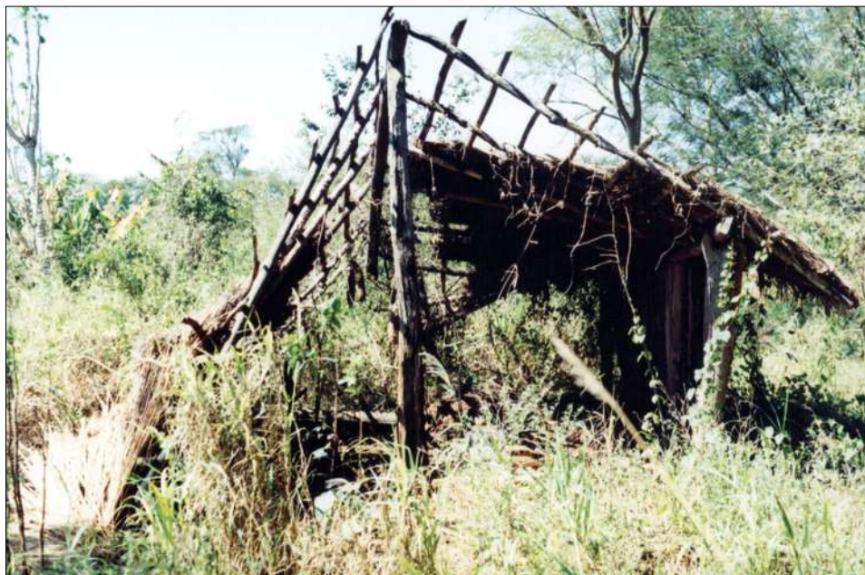
Foto xx. Vista frontal da casa em colapso, fevereiro 2003
