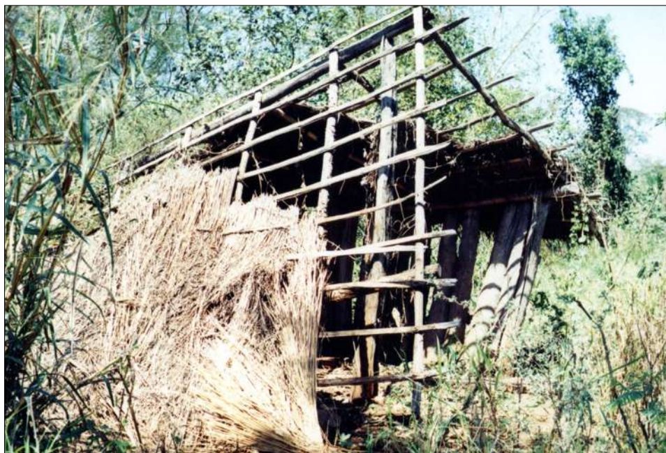
Foto 98. Vista lateral da casa em colapso, fevereiro/2003
