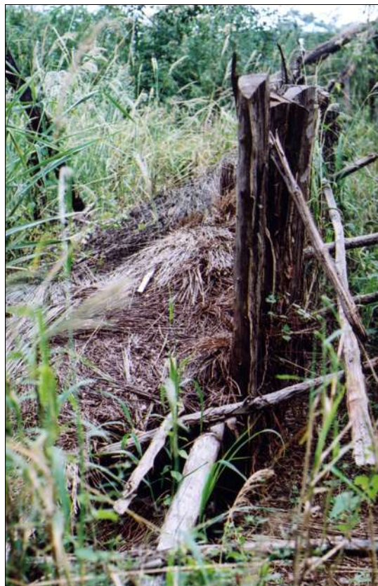
Foto 101. Parede lateral sul, onde se vê a cobertura caída, agosto/2004
