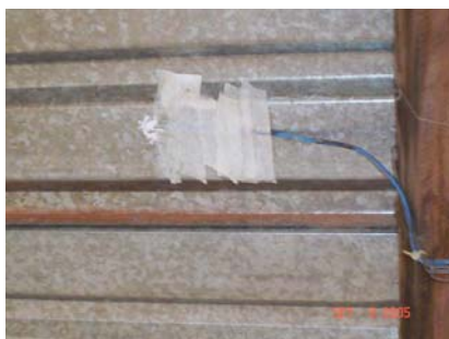
Figura 3.11- Termopar instalado no telhado (com pasta térmica na ponta)
