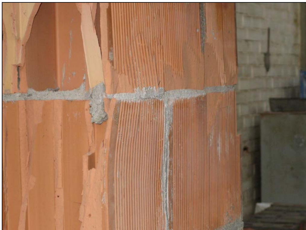
Figura 4.15 – Detalhe do fendilhamento do bloco e esmagamento da argamassa.
