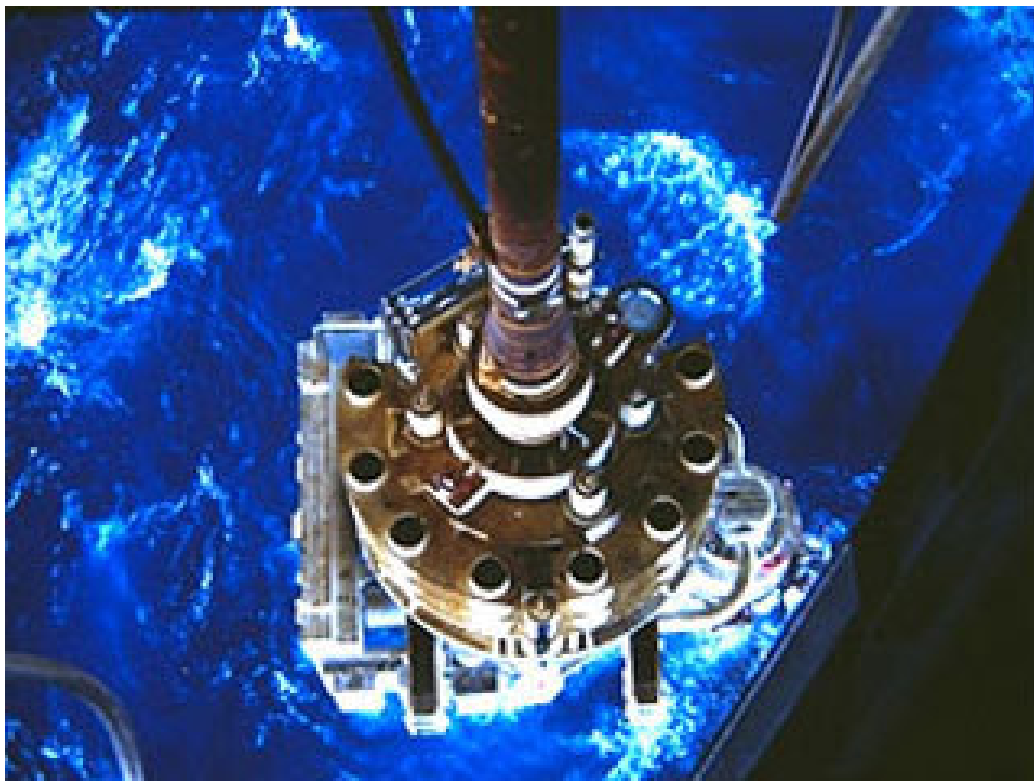
Árvore de Natal molhada do poço de Marlim IV na Bacia de Campos - Campos – RJ
