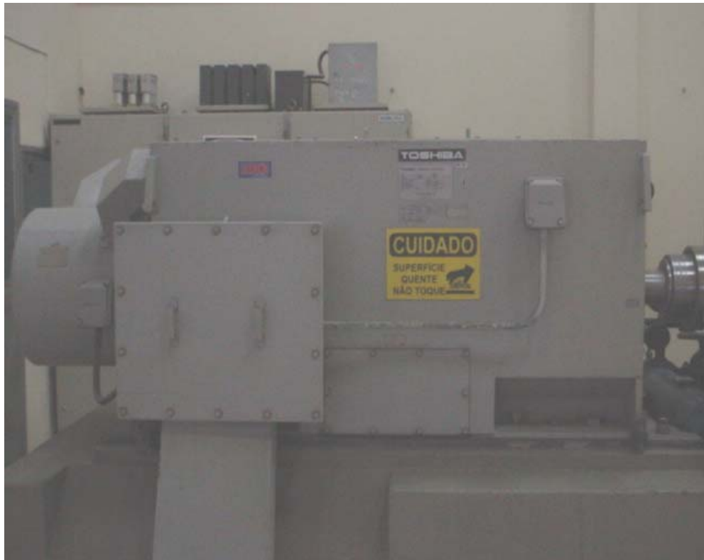
FIGURA 10 - Gerador da Empresa Urbano Agroindustrial (reprodução autorizada).
