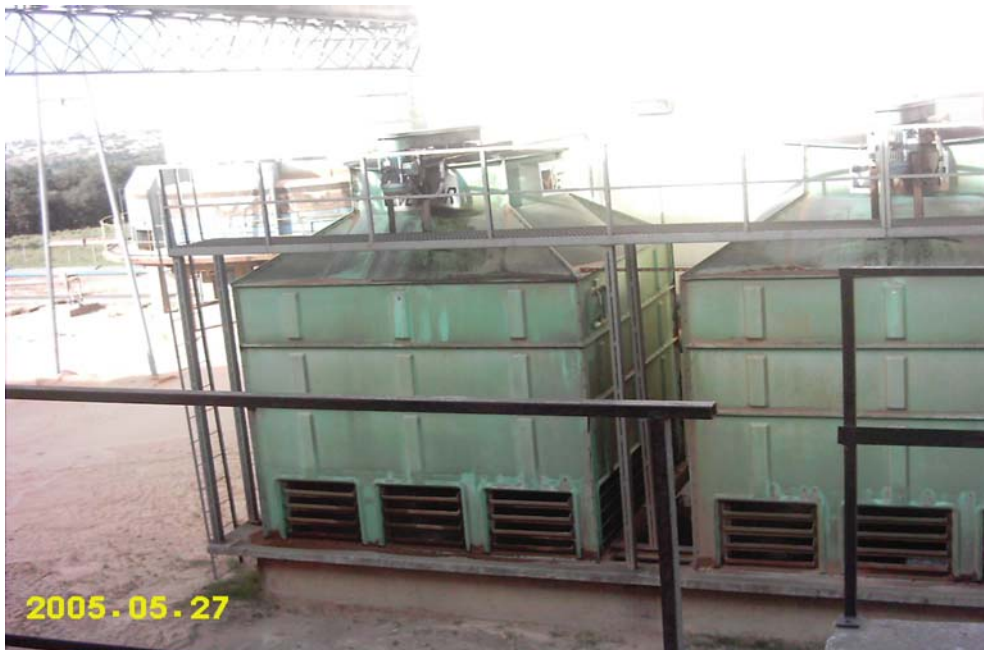
FIGURA 6 - Torres de refrigeração de água da Empresa Forjasul S. A. (reprodução autorizada).
