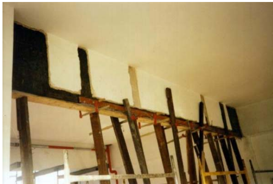
(c) Execução do Escoramento do Reforço da Viga para Cura da Cola
