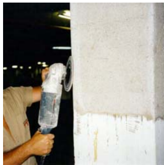
(c) Arredondamento das Arestas de Canto do Pilar com Raio de 10 mm
