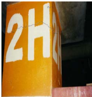
(a) Vista do Pilar Fissurado Antes do Reforço
