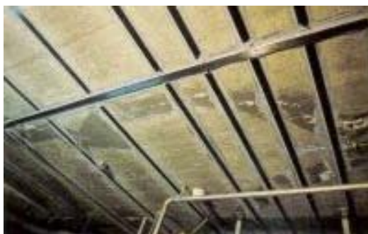
Figura 2.17 – Exemplo de Aplicação de Lâminas de Compósitos de Resina e Fibras de Carbono no Reforço de Lajes de Concreto. Disponível em: < http://www.ecn.purdue.edu/ECT/Civil/cfrp.htm >. Acesso em: jul. 2003
