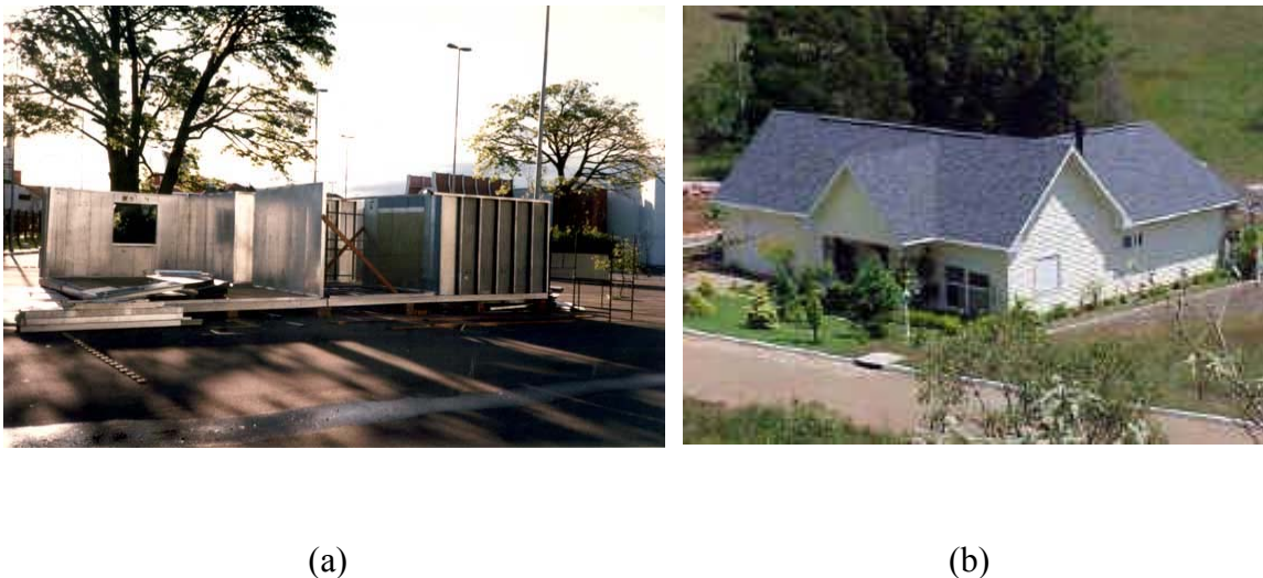
Figura 2.3 Construção residencial baixa em painel diafragma [18]: (a) durante a montagem, (b) residência concluída.
