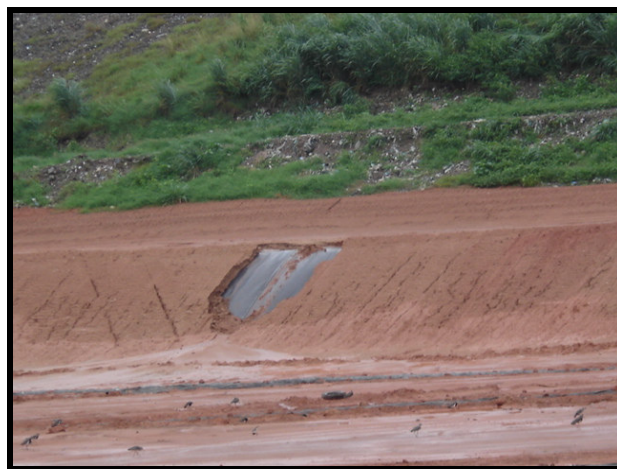
Figura 9.55: Escorregamento de cobertura de impermeabilização no aterro 14.
