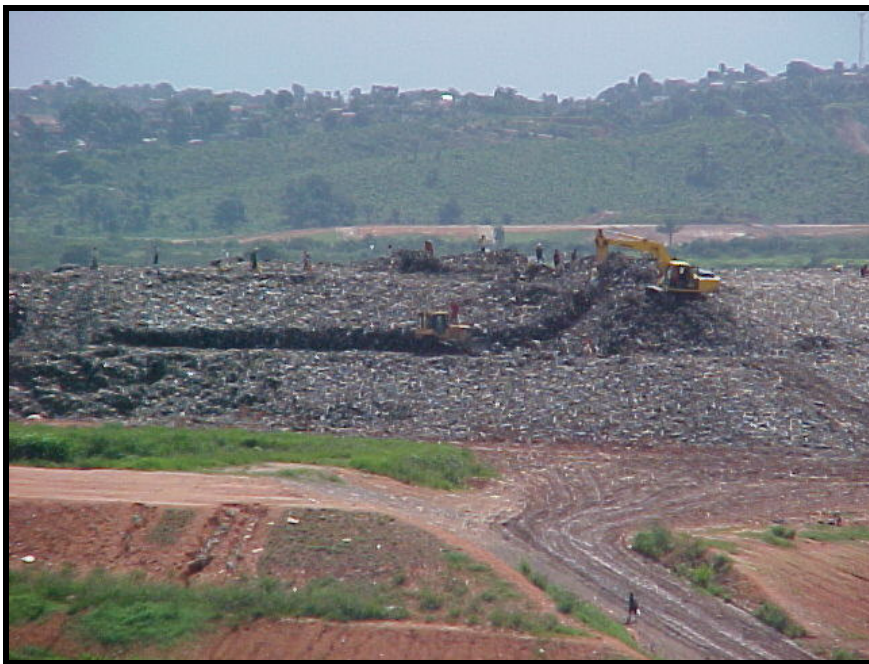
Figura 9.6: Frente de trabalho sem recobrimento e com muitos catadores no aterro 01.
