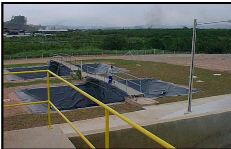
Figura 9.14: Tanques de polimento do sistema de nanofiltração de chorume no aterro 03
