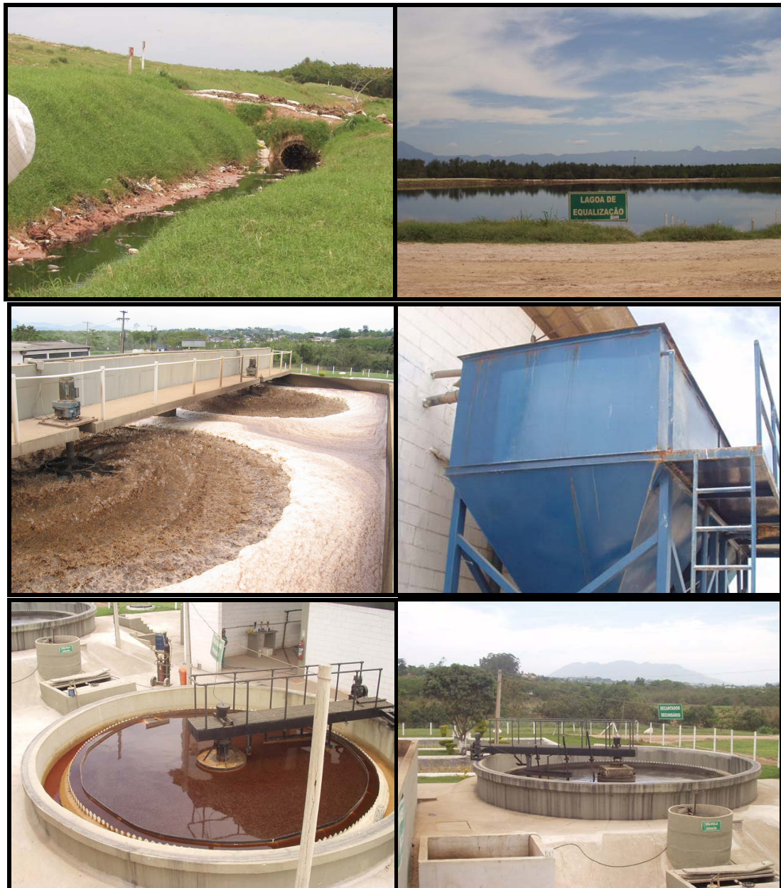
Figura 9.11: Sistema de coleta e tratamento de chorume no aterro 03
