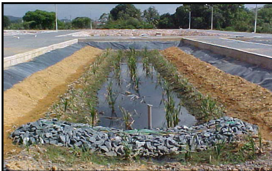
Figura 9.5: Barreira bioquímica do sistema de tratamento de chorume no aterro 01.
