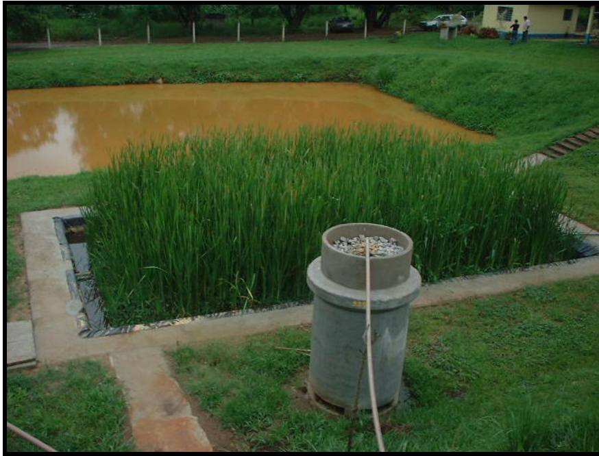
Figura 9.46: Sistema de tratamento fito-biológico de chorume no aterro 11.
