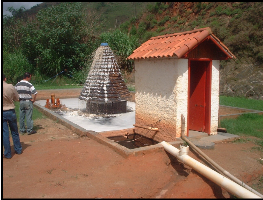
Figura 9.31: Sistema de coleta e tratamento de lixiviados no aterro 06.
