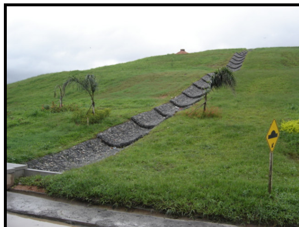
Figura 9.56: Sistema de drenagem de águas pluviais definitiva no aterro 14.
