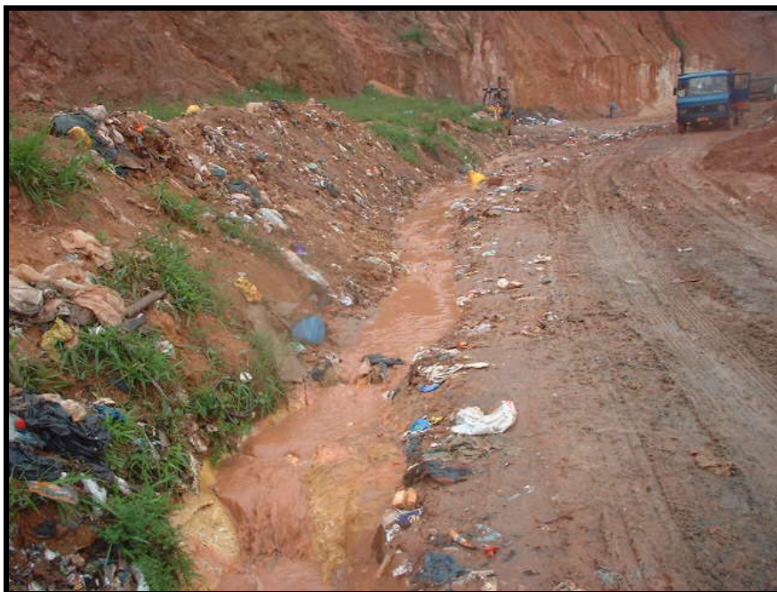
Figura 9.48: Drenagem de águas pluviais provisória em péssimo estado no aterro 12.
