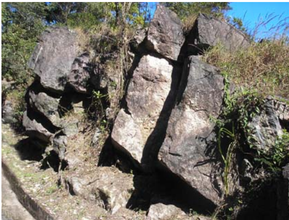
Figura 4. 14 Ocorrência rocha fraturada na rua Ferreira da Cunha (Duques)
