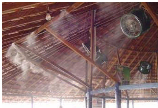
Figura 2.1 – Sistema de resfriamento evaporativo com aspersão. Fonte: Climasystem
