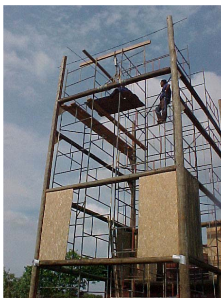
Figura 41 – Montagem do Edifício Experimental composto por sistema pilar viga em eucalipto roliço e painéis estruturais.
