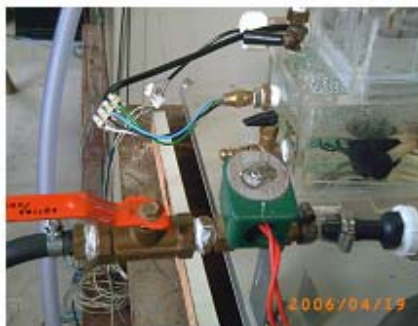
e) Válvula Solenóide de Controle de Ar
