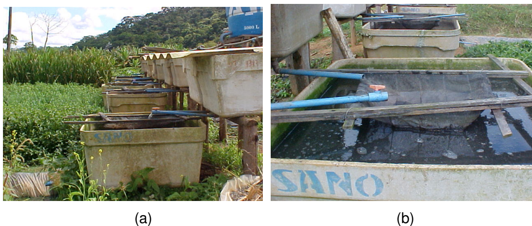
Figura 10. Sistema de tratamento primário, constituído pelos filtros orgânicos e pelas caixas de controle (a) e detalhe de uma caixa de controle (b)
