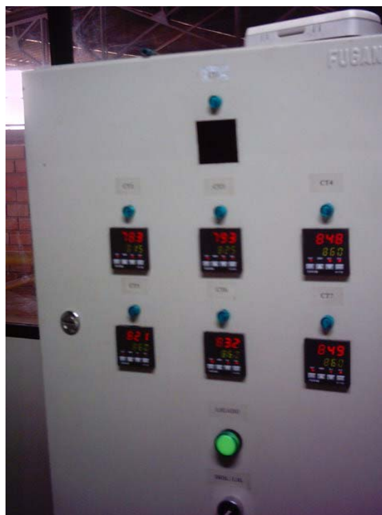
Foto II.29: Sistema automatizado para controle de forno
