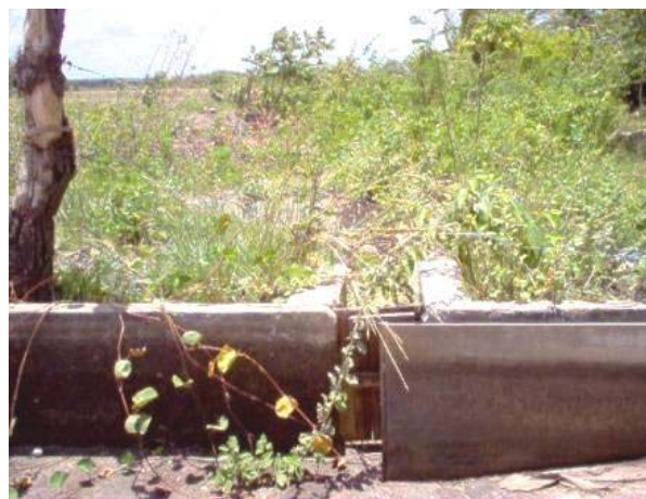
Figura 22 – Infra-estruturas sucateadas do PIMN. Fonte: Pesquisa Direta, 2005.
