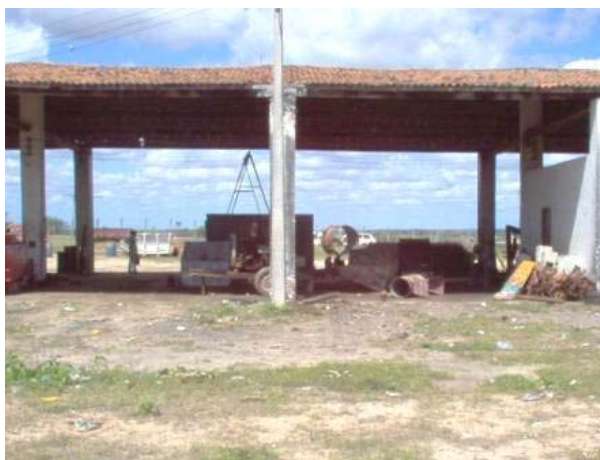
Figura 21 – Infra-estruturas sucateadas do PIMN. Fonte: Pesquisa Direta, 2005.
