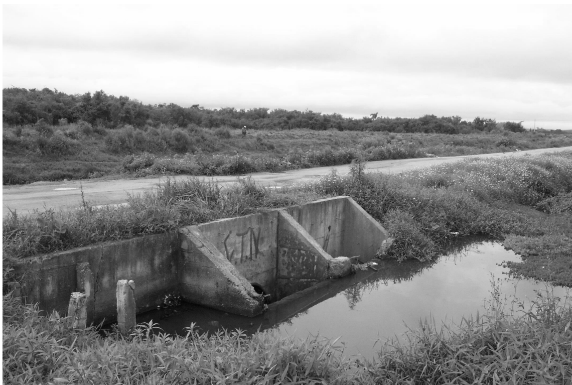
FIGURA 4.15 SIFÃO PARA COLETA DE ÁGUAS SUPERFICIAIS DO JARDIM GUARITUBA E TRANSPOSIÇÃO DAS MESMAS ATRAVÉS DO CANAL EXTRAVASOR
