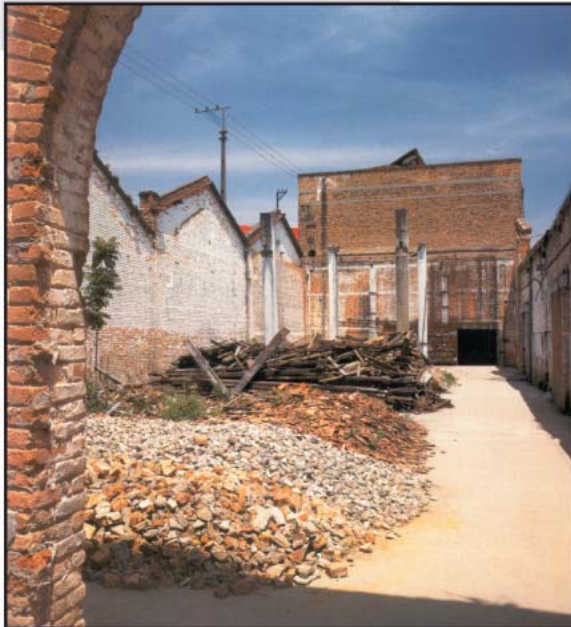
Depósito/mostruário de materiais retirados - Galpões Matarazzo
