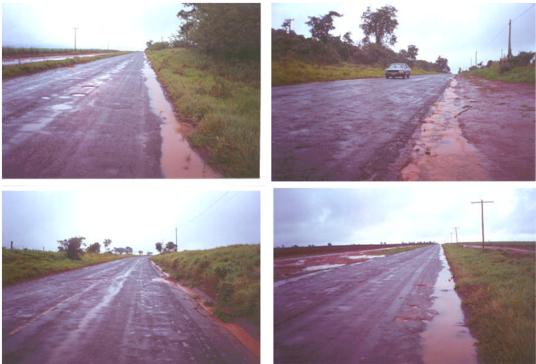
Figura 6 - Ilustração de revestimento e acúmulo de água em segmentos observados, antes de reconstrução e manutenção (Fonte: PALMA, 2000)
