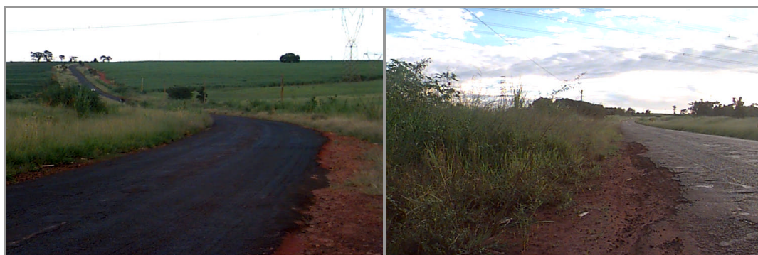
Figura 5 – Ilustração de aparência e geometria de segmento na ligação Araraquara - Gavião Peixoto, antes de reconstrução e manutenção (Fonte: DARONCHO, 2001)
