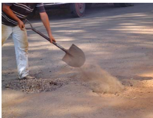
Figura 6.13 – Serviço executado de forma incorreta: uso de material solto para completar a panela
