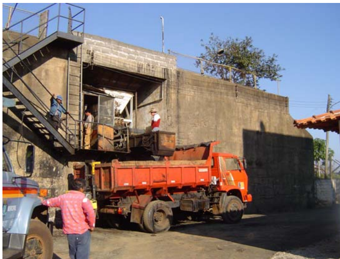
Figura 6.3 – Usina para preparação de PMF da Prefeitura Municipal de São Carlos
