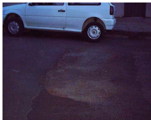
Figura 1.2 –Defeito em reparo de vala na cidade de São Carlos
