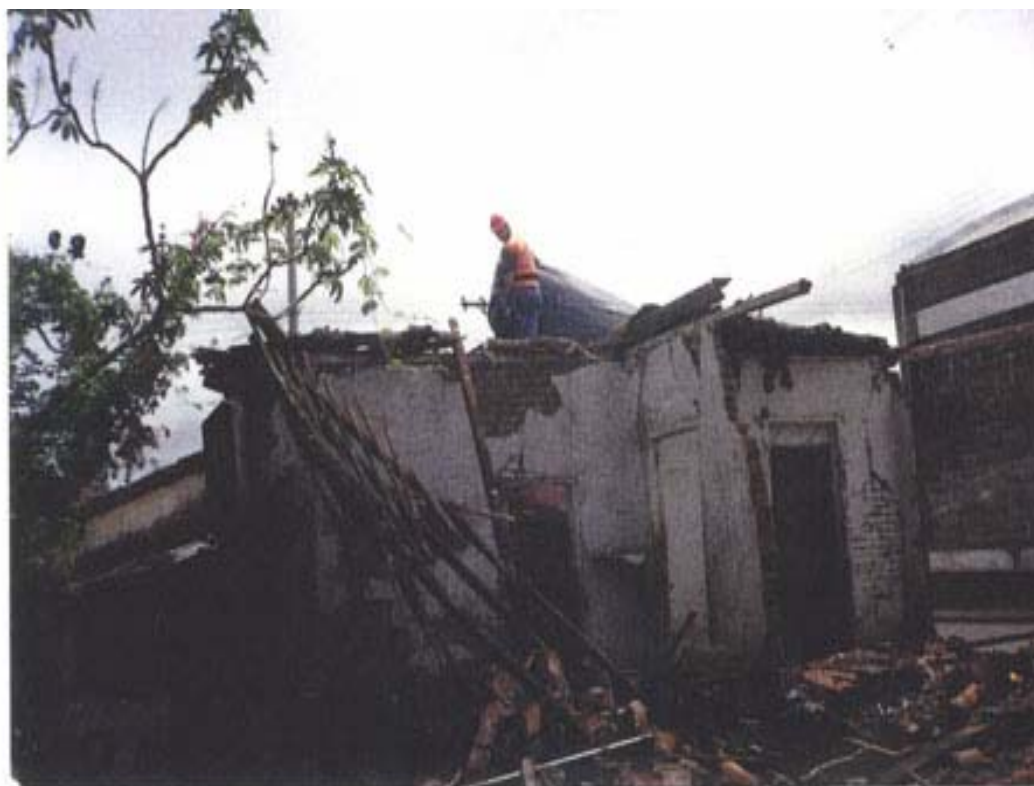
Figura 02: Destelhamento total e desabamento parcial de residência em São Carlos, Estado de São Paulo, por ocasião de um vendaval com ventos de 120 km hora por um fenômeno hidrometeorológico chamado de “tesoura de vento”(descrito no Anexo 02). Fonte: Caballero, 1999.
