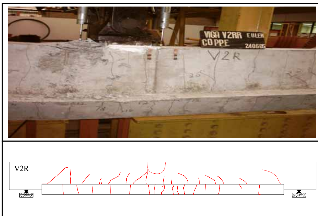
Figura 3.52 – Fissuração e aspecto pós-ruptura da viga V2R.
