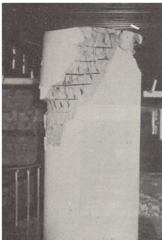
Figura 5.7: Vista de uma coluna danificada do eixo 5 do andar mezanino (Foto da revista do Instituto de Materiales y Modelos Estructurales. Caracas Janeiro 1980).
