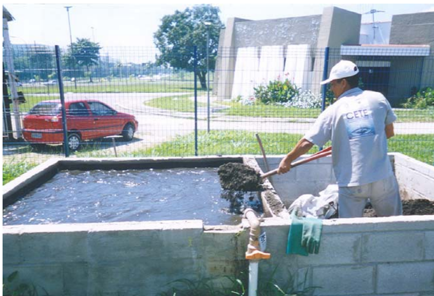
Figura 3. 5 - Tanque de equalização de lodo
