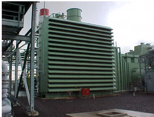
Figura 2.4 – Sistema de entrada de ar da turbina a gás.
