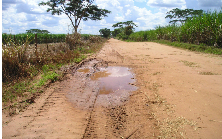
Figura 10 - “Sulcos provocados por erosão” (NvE-361, Nova Europa, estado de São Paulo, agosto de 2004)
