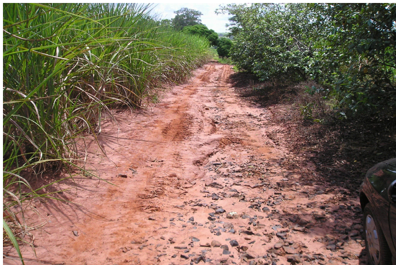
Figura 11 - Atoleiros e segregação de materiais em rodovia não-pavimentada (NvE-460, Nova Europa, estado de São Paulo, agosto de 2004).
