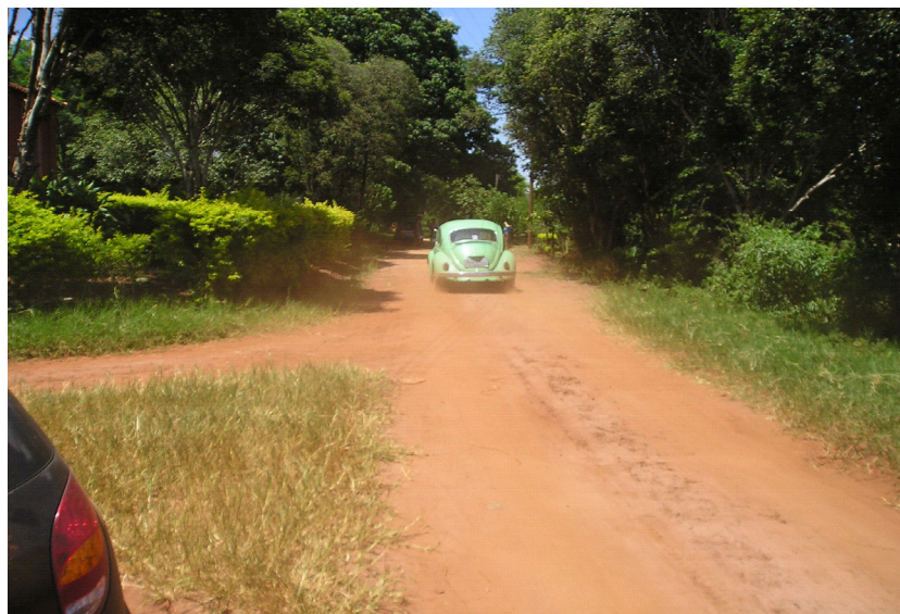
Figura 3 – Poeira, um dos defeitos de rodovia não-pavimentada (NvE-460, Nova Europa, estado de São Paulo, agosto de 2004)
