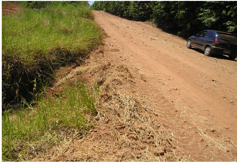
Figura 7 - Segmento de rodovia não-pavimentada com defeitos na drenagem superficial (Rodovia NvE-030, Nova Europa, estado de São Paulo, agosto de 2004)
