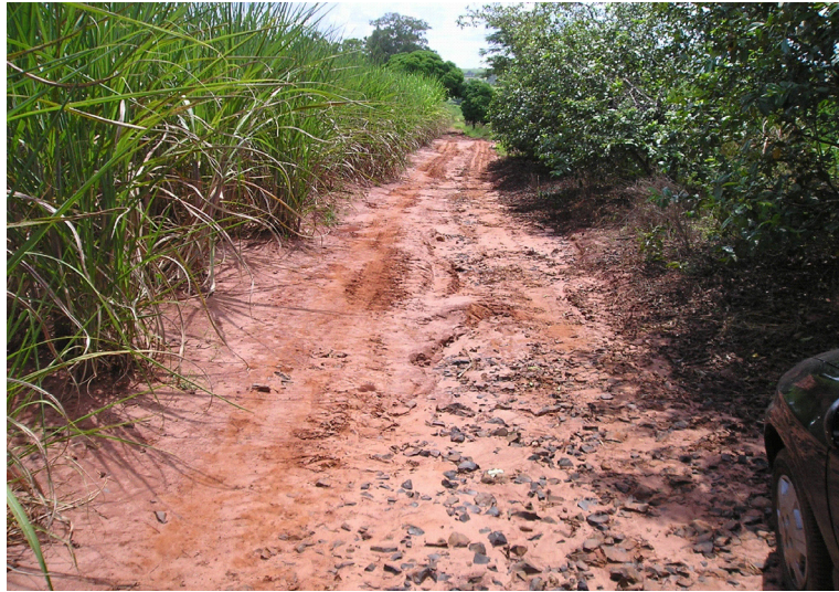
Figura 5 - “Corrugação” em rodovia não-pavimentada (Rodovia NvE-050, Nova Europa, estado de São Paulo, setembro de 2004)
