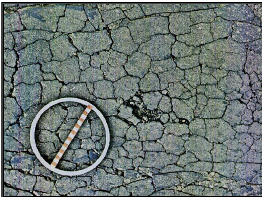
Figura 3.1: Trincamento por Fadiga, DNIT (2003)
