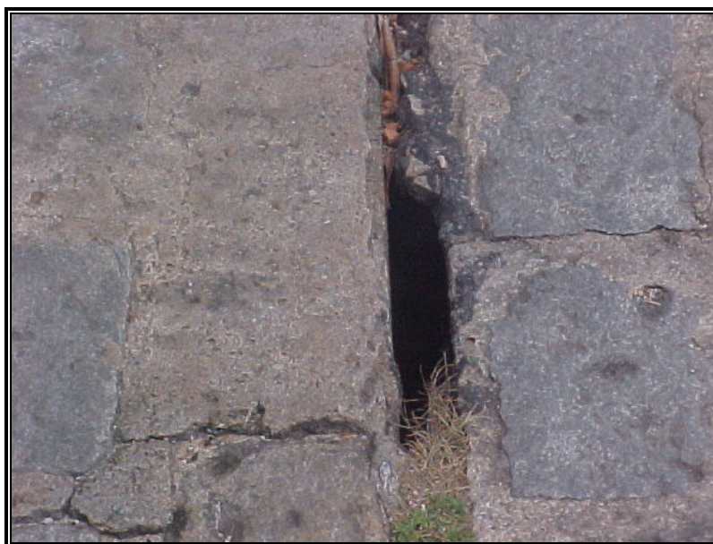
Figura 6.25: Falha na Vedação da Junta da Ponte com Calçamento
