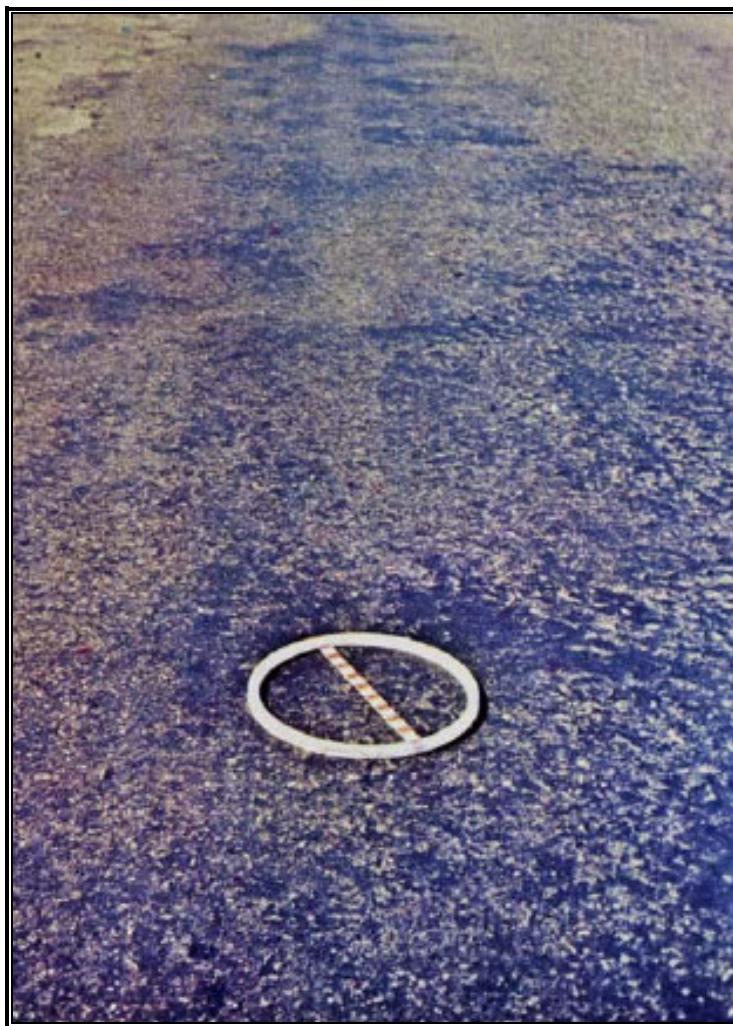
Figura 3.9: Exsudação no Pavimento, DNIT (2003)
