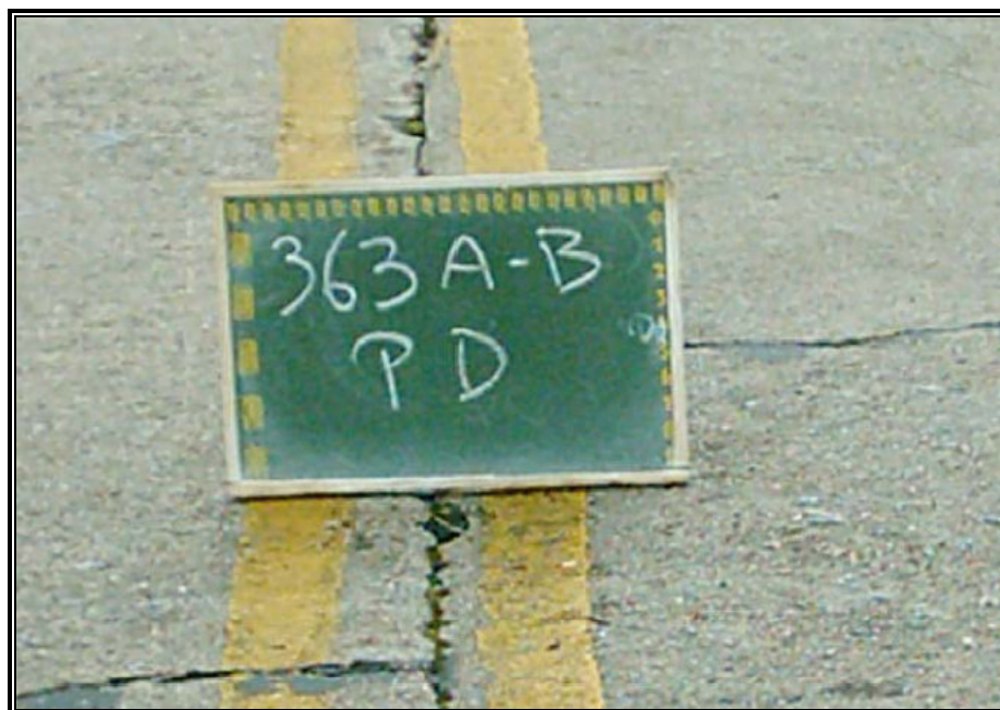
Figura 3.13: Falha na Selagem das Juntas, DNIT (2004)
