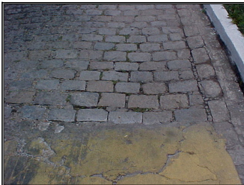
Figura 6.24: Afundamento Localizado da Seção 02.
