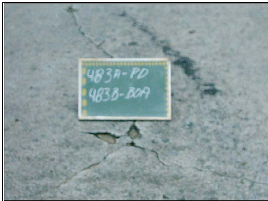
Figura 3.23: Buracos em placa de concreto, DNIT (2004)
