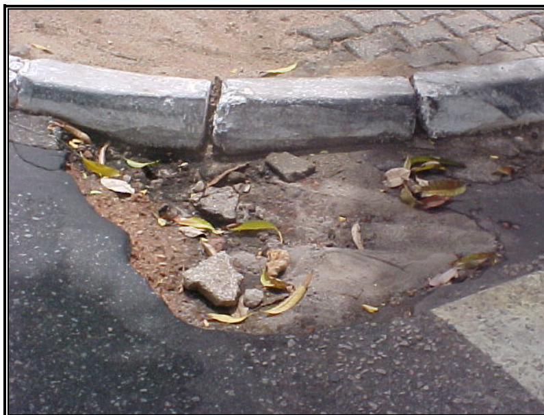
Figura 6.21: Buraco ou Panela da Seção 01.
