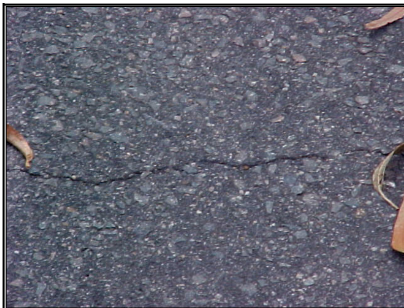
Figura 6.19: Trincas Transversais da Seção 01
