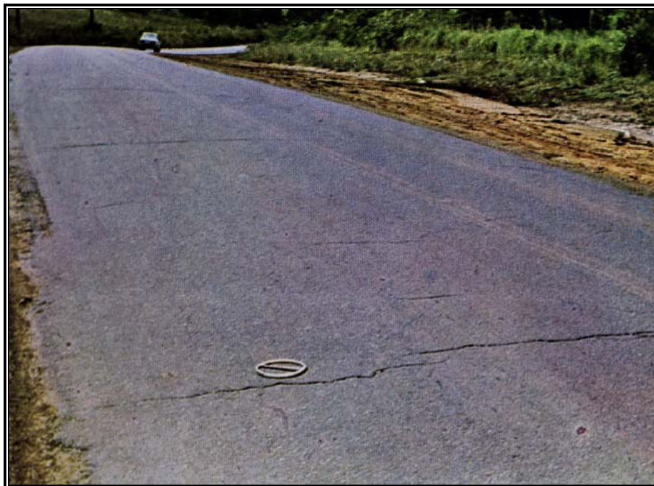
Figura 3.2: Trincamento Transversal, DNIT (2003)
