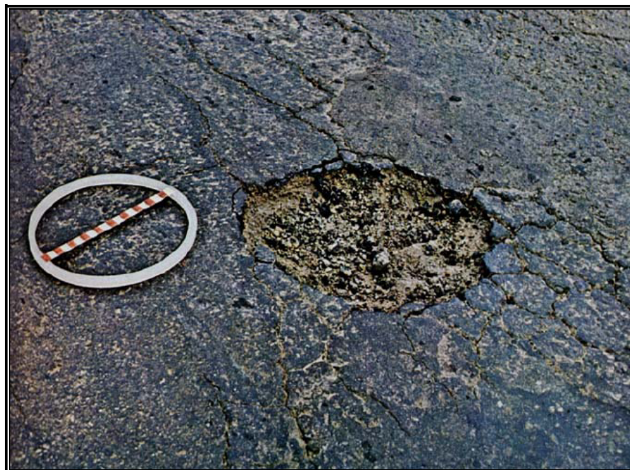
Figura 3.6: Painelas no Pavimento Asfáltico, DNIT (2003)
