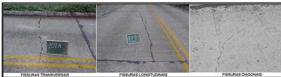
Figura 3.14: Tipos de Fissuras Lineares, DNIT (2004)
