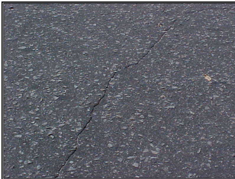
Figura 6.20: Trincas Longitudinais da Seção 01
