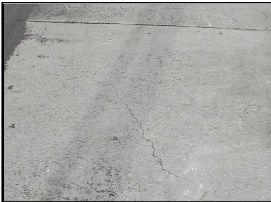
Figura 3.18: Fissura Superficial, DNIT (2004)
