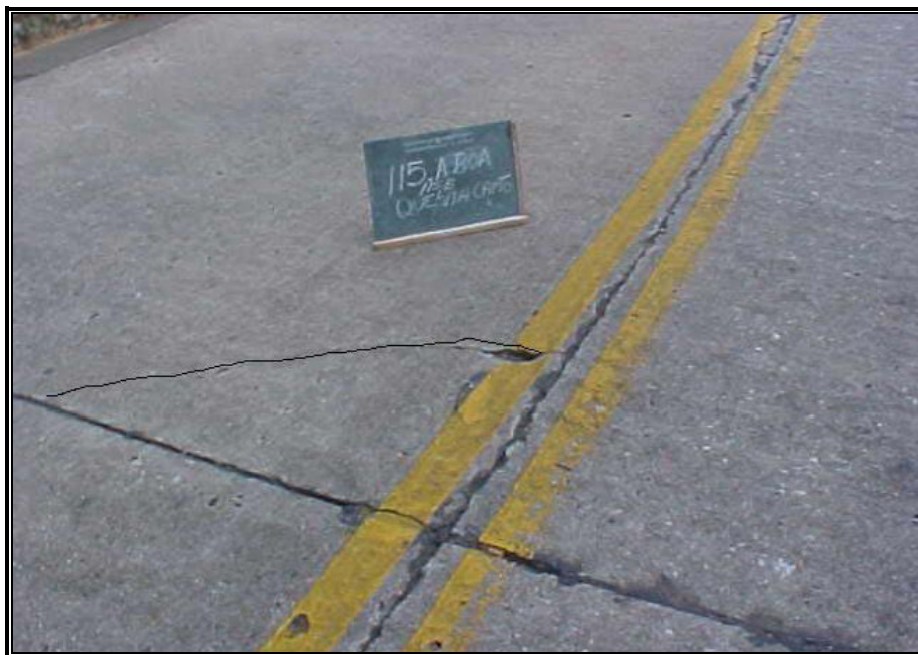
Figura 3.11: Fissura de Canto, DNIT (2004)
