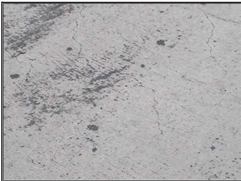
Figura 3.19: Fissura de Retração Plástica, DNIT (2004)
