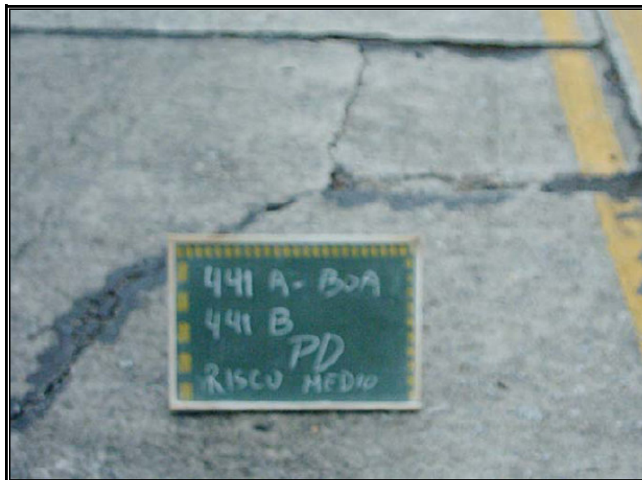
Figura 3.22: Assentamento em placa de concreto, DNIT (2004)
