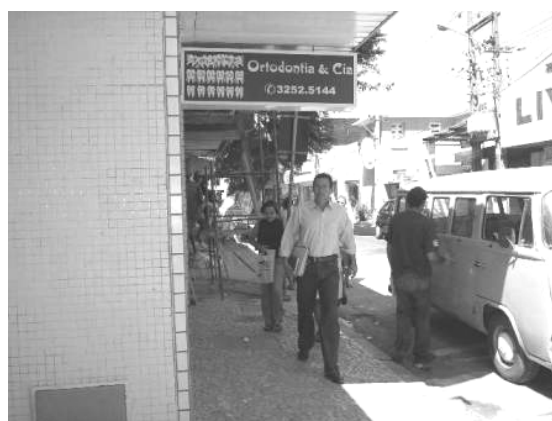
Figura 3.9: Execução de obra sobre o passeio sem a devida sinalização no Centro de Fortaleza-CE (2005).
