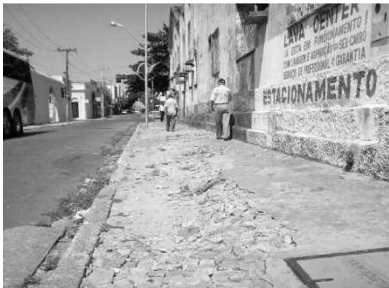
Figura 3.8: Calçada com superfície esburacada dificultando a circulação dos pedestres no Centro de Fortaleza-CE (2005).
