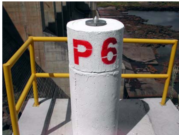
FIGURA 22 - PILAR DE CENTRAGEM FORÇADA LOCALIZADO EM UMA DAS ENTRADAS DA GALERIA SUPERIOR
