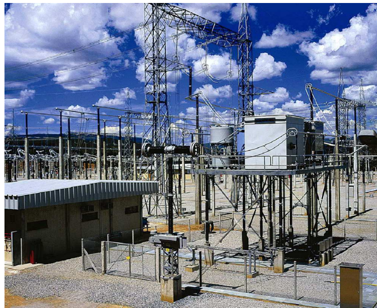
Figura 2.7: TCSCs instalados na subestação de Serra da Mesa - FURNAS
