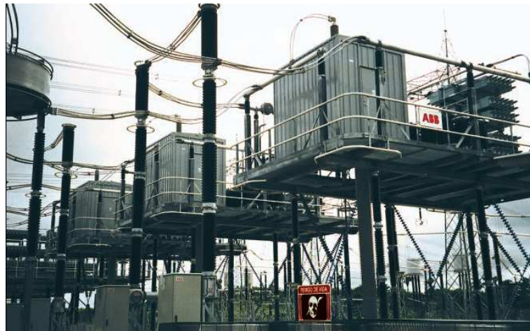
Figura 2.6: TCSCs instalados na subestação de Imperatriz
