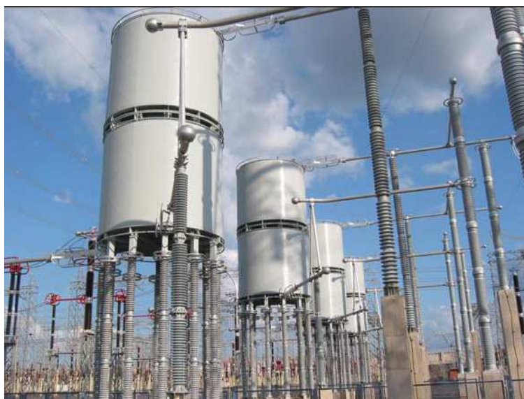
Figura 1.2: Reator limitador da subestação de Tucuruí
