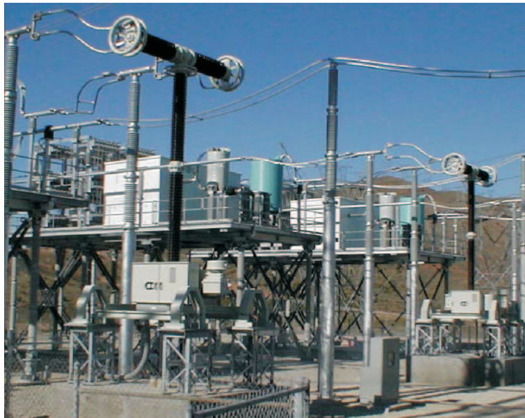
Figura 2.3: TPSCs 500 kV instalados na subestação em Vincent/USA
