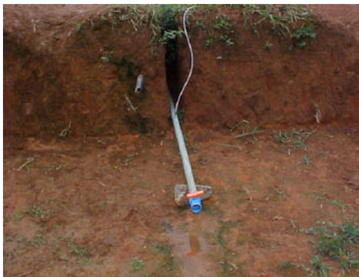
Figura 7 – Vista parcial do sistema “wetland”. Saída da água após percorrer o tanque.
