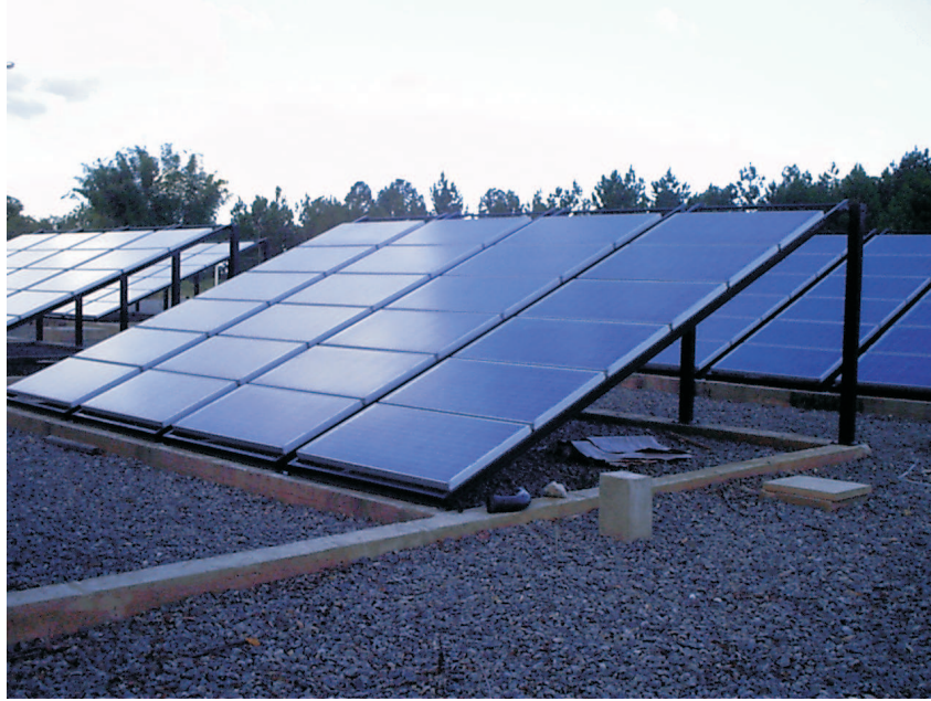
Figura 6.1: Foto com os Arranjos dos Painéis Solares Fotovoltaicos.
