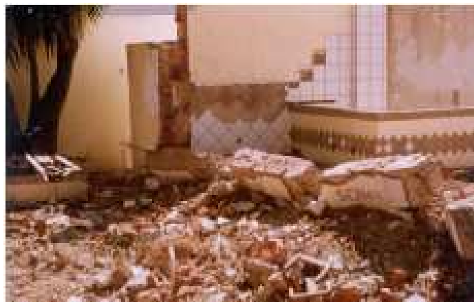
FIG.2.1 Mistura de materiais de resíduos de construção e demolição pela ausência de gestão em demolições (JOHN, 2000).
