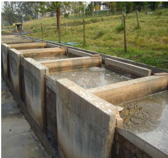
Figura 11 - Tanque de Decantação
