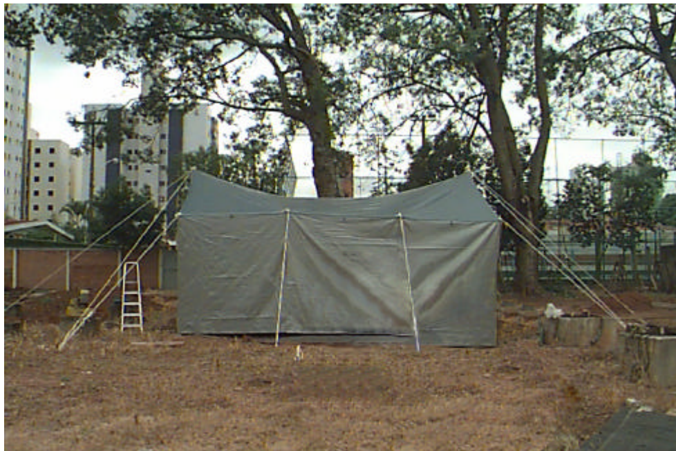
Figura 3.16 – Barraca de proteção
