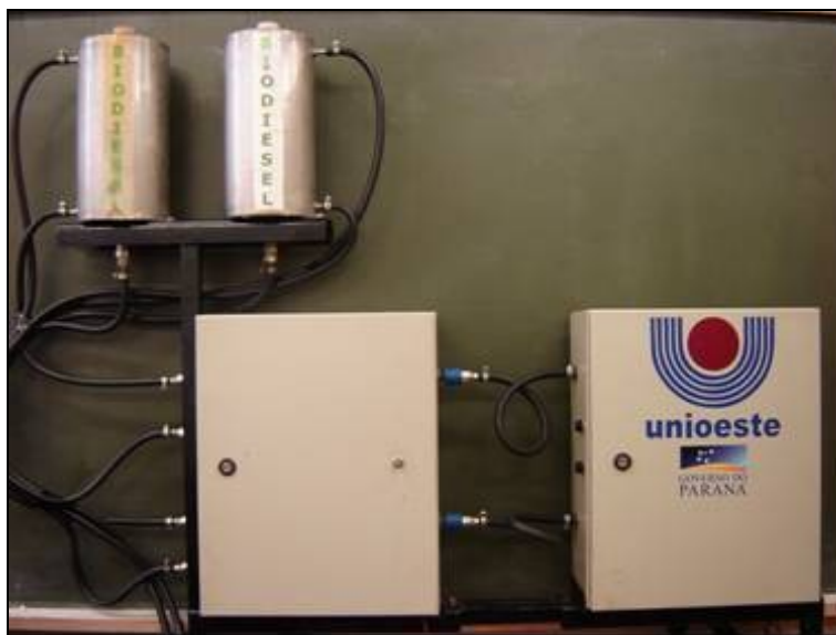
Figura 16 - Vista frontal do sistema automatizado, composto pelos tanques auxiliares e quadros de controle e medição.
