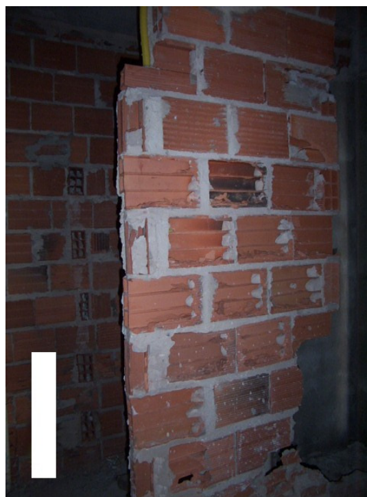
Figura 6.4: Quebra da alvenaria por um erro de locação da parede.
