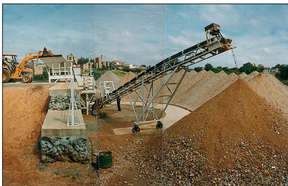
Figura 3.2 – Usina de britagem de resíduo classe A em Belo Horizonte
