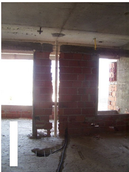
Figura 6.3: Quebra da alvenaria e do concreto para montagem da instalação hidrossanitária (parede) e elétrica (piso)
