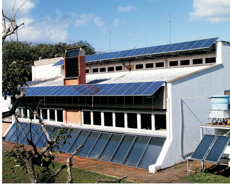
Figura 1.25: Fachada do prédio do Laboratório de Energia Solar da UFRGS com os módulos instalados.
