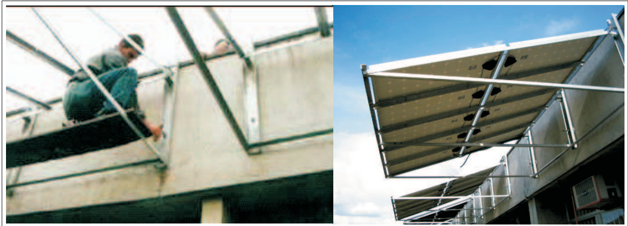
Figura 4.3: Vista lateral inferior com detalhes da montagem da estrutura utilizada para alojar os módulos fotovoltaicos.
