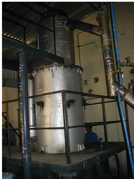
Figura 13. Foto do gaseificador de 20 kW instalado na vila Hosahalli
