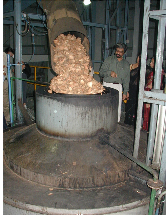
Figura 26. Topo do Gaseificador sendo alimentado com biomassa
