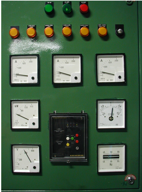
Figura 27. Quadro da saída de força da usina
