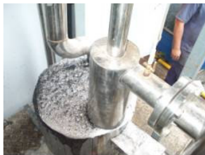
Figura 62 - Formação de espuma no selo d'água do lavador primário
