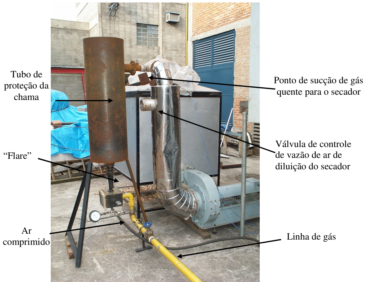
Figura 53 - “Flare” com injeção de ar comprimido
