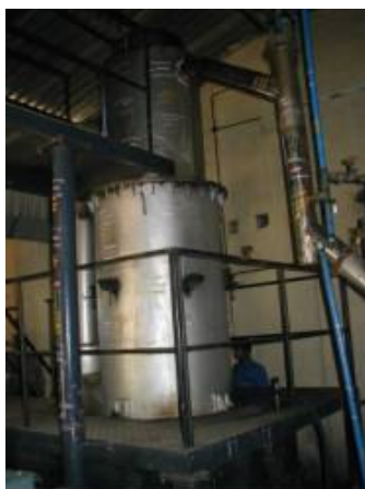
Figura 26 – Gaseificador de 20 kW instalado na Vila Hoshalli Fonte: CENBIO, 2002c.
