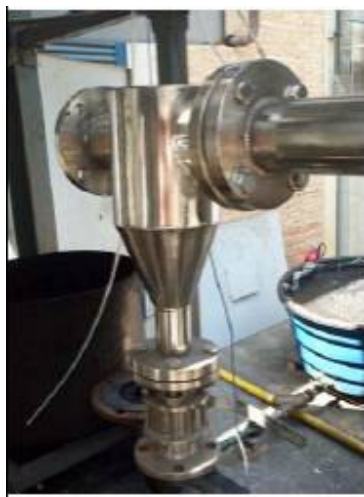
Figura 72 - Foto do sistema separador de gotas instalado na saída do sistema primário de lavagem de gases
