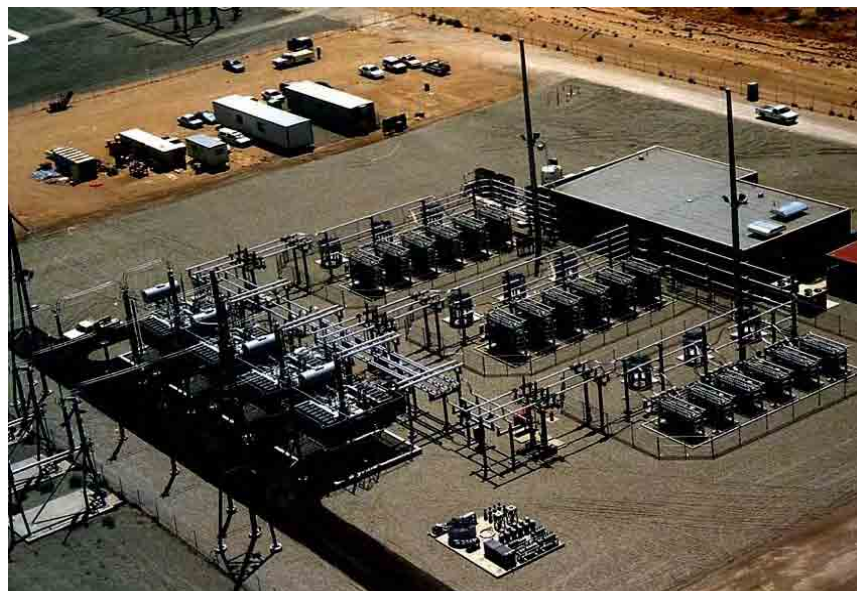
Fig. A.9: Plataforma SVC – Mead-Adelanto – Estados Unidos – 500 kV, 387,5 MVar.
