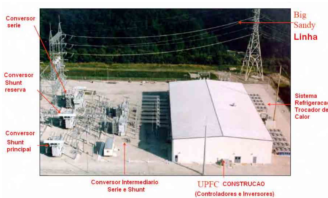
Fig. A.5: Instalações – Big Sandy – Subestação Inez
