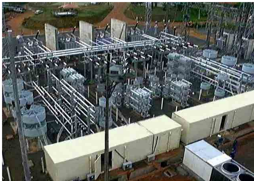
Fig. A.10: Plataforma SVC Funil – 230 kv, 20 MVar cap / 100 MVar ind.
