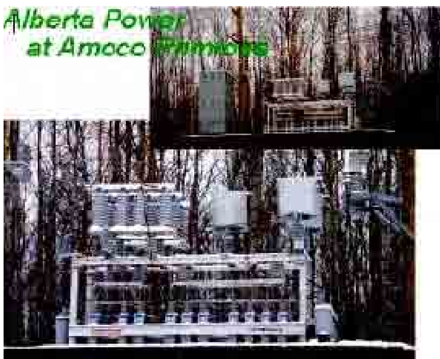
Fig. A.31: Capacitor Série Distribuição(DSC-Distribution Series Capacitor)
