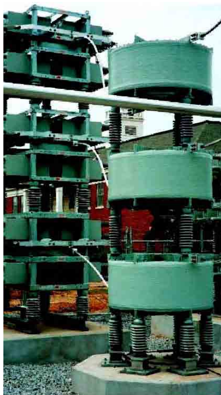
Fig. A.28: Filtros passivos , com bancos de capacitores com reatores de sintonização adequados e resistores de amortecimento.
