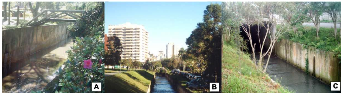
CANAIS DE SEÇÃO TRANSVERSAL TIPO "U" - (A) RIO BELÉM - BOSQUE DO PAPA, (B) RIO BELÉM - CENTRO CÍVICO, (C) RIO GUAÍRA - GUAÍRA
