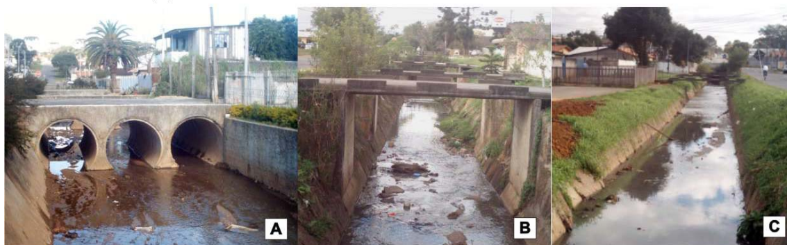
CANAIS DE SEÇÃO TRANSVERSAL TIPO "U" - (A) RIO BELÉM - CANAL DE MENOR PROFUNDIDADE E MAIOR LARGURA (ABRANCHES), (B, C) CÓRREGO EVARISTO DA VEIGA - CALHA EM CONCRETO/ CONCRETO COM TALUDES NATURAIS
