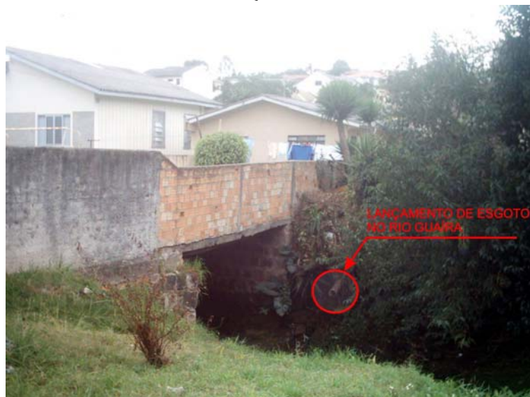
FIGURA 24 – EXEMPLO DE LANÇAMENTO IRREGULAR DE ESGOTO
