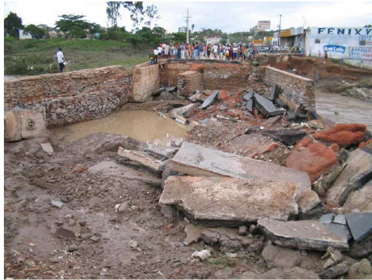
Foto 22: Cabeceira da ponte do Galucho destruída.
