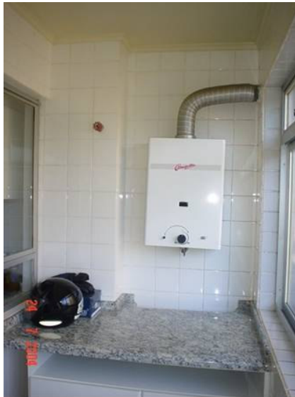
FIGURA 4.13 – AQUECEDOR DE PASSAGEM DOS APARTAMENTOS
