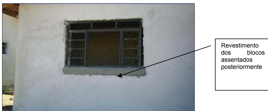
FIGURA 4.25 - REVESTIMENTO JUNTO À ESQUADRIA
