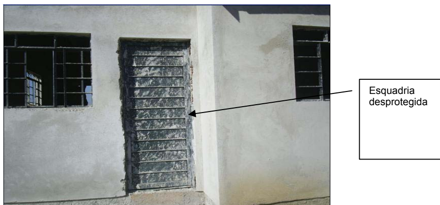
FIGURA 4.27 - FALTA DE PROTEÇÃO NA ESQUADRIA
