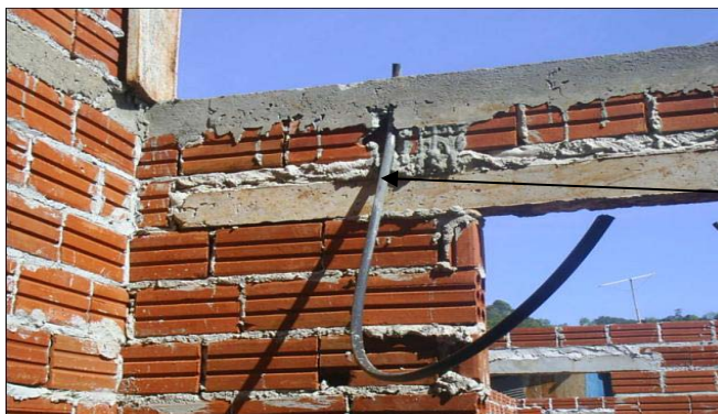
FIGURA 4.22 -PASSAGEM PARA TUBULAÇÃO ELÉTRICA OBSTRUÍDA PELA VERGA
