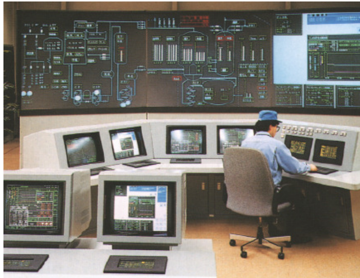
Figura 4: Exemplo de sala de controle da década de 90
