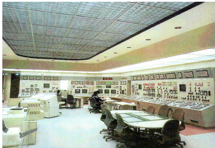
Figura 3: Exemplo de sala de controle de usina nuclear , década de 80
