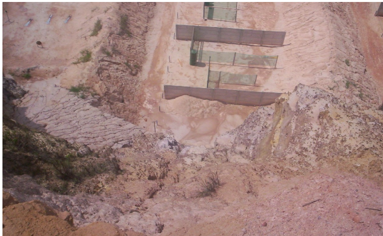
Figura 20 - ENCOSTA APRESENTANDO INTENSO PROCESSO EROSIVO
